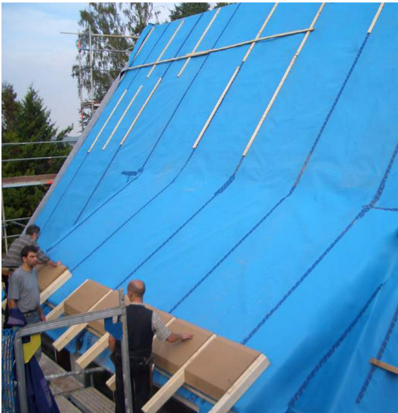
Abb. 7.2: Nachträgliche Dachsanierung von außen beim Energie- und Umweltzentrum e.u.[z.], Springe: Luftdichtheit durch verklebte Unterspannbahnen und Tauwasserschutz durch zusätzliche Aufdachdämmung.
